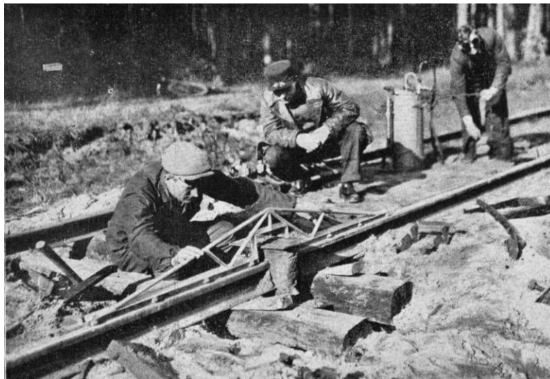
Rys. 18. Sprawdzanie liniałem 2-metrowym prostoliniowości po zdjęciu aparatu zaciskowego, przed usunięciem formy (możliwość prostowania na gorąco) [1]
