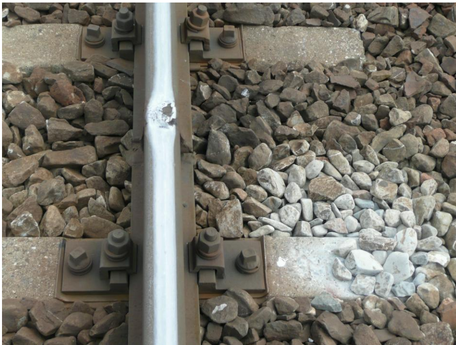
Rys. 3. Wytrysk (wchłapka) pod podkładem znajdującym się w pobliżu wady squat na spoinie termitowej
