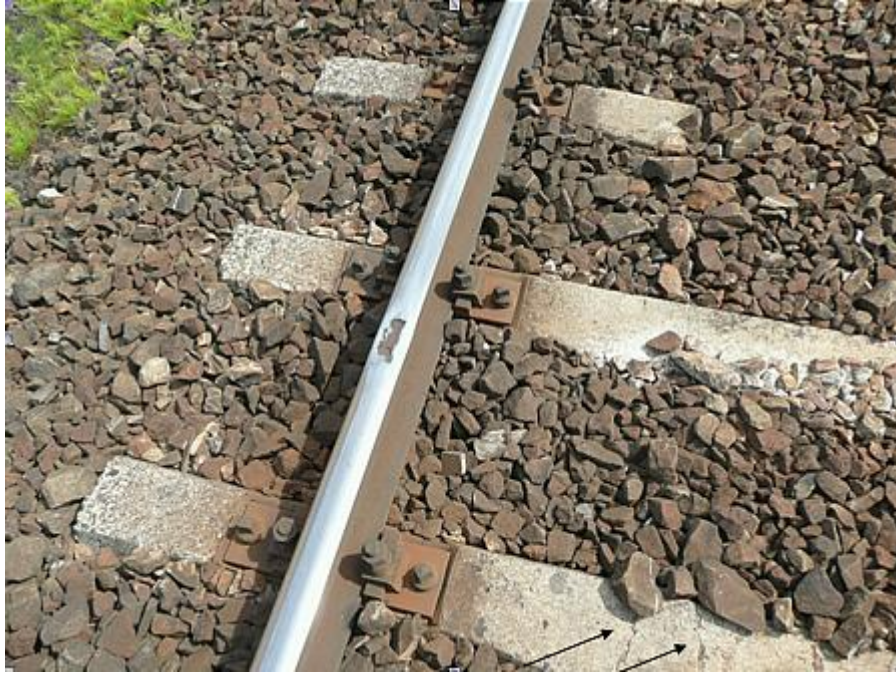
Rys. 2. Pęknięcia podkładu (oznaczone strzałkami) w strefie powierzchniowej wady szyny
