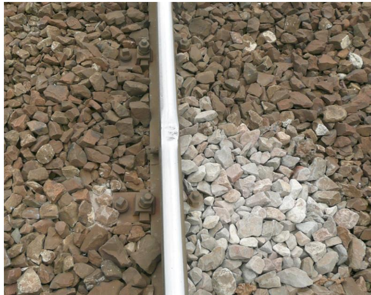
Rys. 1. Zagłębienie na spoinie termitowej 2 mm i jego skutek w postaci wychłapków (fot. ze zbiorów IK)
