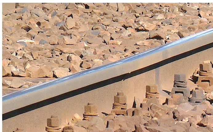
Rys. 9. Niedokładne ustawienie szyny do zgrzewania; widoczne przesunięcia pasm współpracy; nierówność pionowa 2 mm (fot. M. Bałuch)
