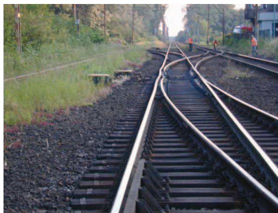
Fot. 9. Wyboczenie – kolejność wykonywania spoin w rozjeździe nie zachowana, temp. wykonywania połączeń +2^{\circ}\text{C} do -5^{\circ}\text{C}
