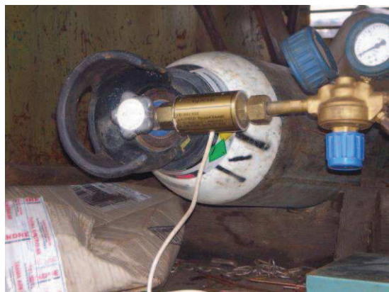
Fot. 13. Podgrzewacz elektryczny. Widok podłączenia reduktora.
