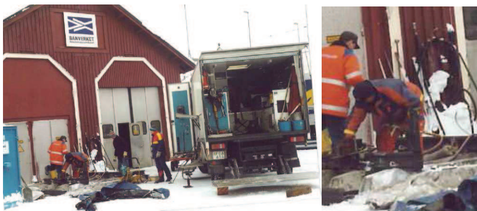
Foto 1a i 1b. Na zdjęciach widać, że węże wchodzą do budynku ogrzewanego
